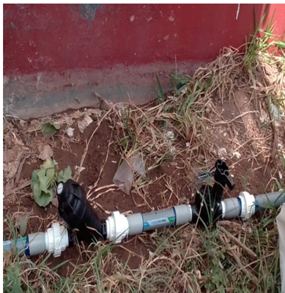
Figura 3.29. Filtro y Electroválvula montado en la tubería.
